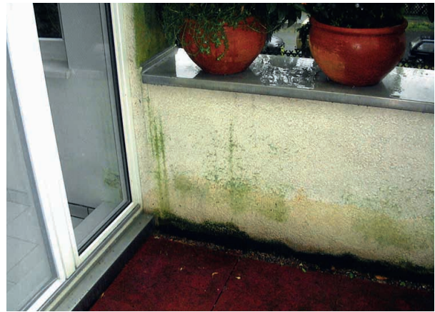
Algenbildung an der Terrassenbegrenzungswand wegen eines mangelhaften Anstriches ohne ausreichende Hydrophobierung und darunter liegendem stark saugenden Untergrund.
